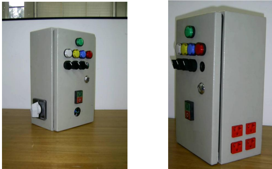
Figura 5.13 – Painel após a montagem, foto da esquerda mostrando a chave geral em uma das laterais, foto da direita mostrando o posicionamento das tomadas.
