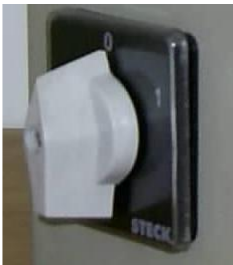
Figura 5.12 – Chave geral para energização do painel
